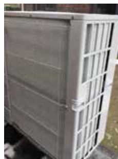
Rijpvorming op de buitenunit is geen probleem. Het systeem zal zelf zorgen dat de wisselaar weer ontdooit wordt.
