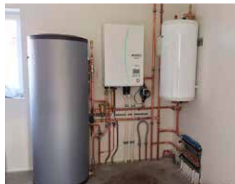
Voorbeeld van een hydrobox-opstelling met een 300 liter boiler en een buffer van 100 liter.
