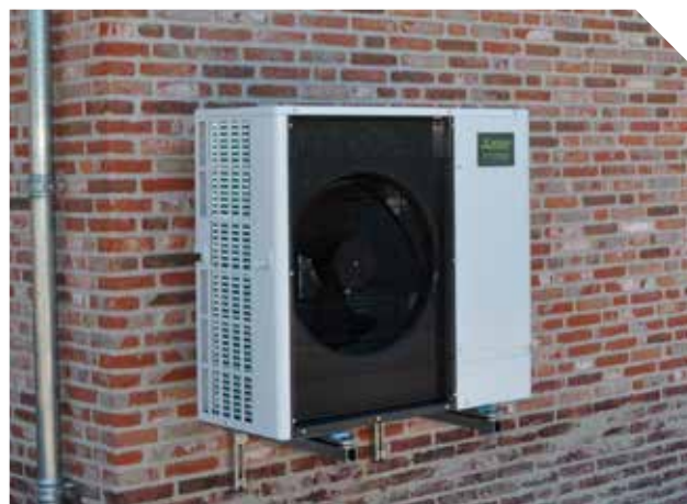
De buitenunit onttrekt energie (warmte) aan de buitenlucht.
